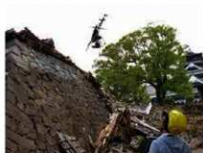
①崩落状況の記録（専員測量）
