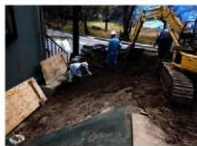
(32) 法面南側の削平
