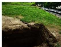
(2) 1トレンチ北 崩落箇所を望む
