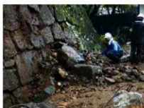
②崩落石材の番号付け
