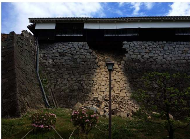
被災後 南から
