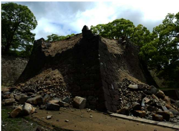
被災後 南西から
