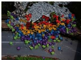
宮内橋際石垣崩落状況石垣色分け
