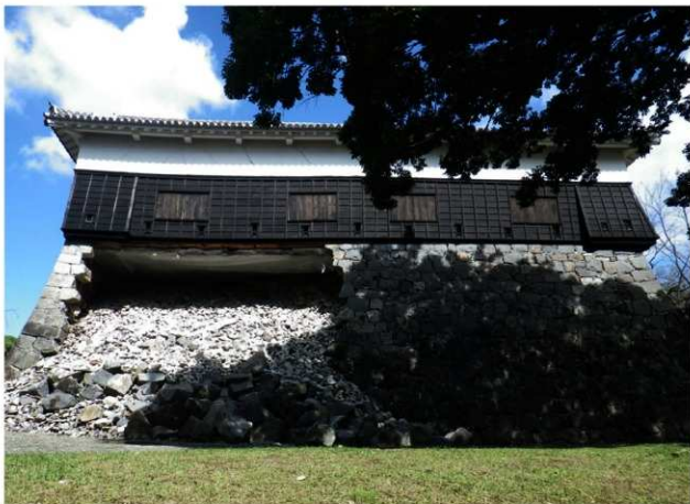
被災後 南から
