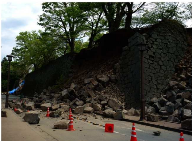
被災後 北西から
