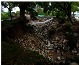
頬当御門口石垣崩壊状況
