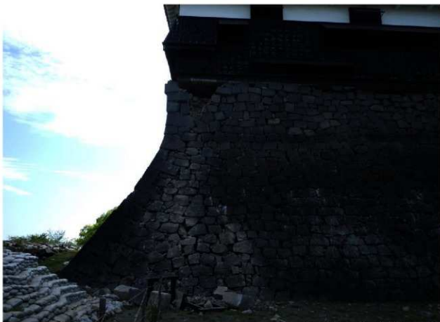
小天守北西石垣 被災後 西から
