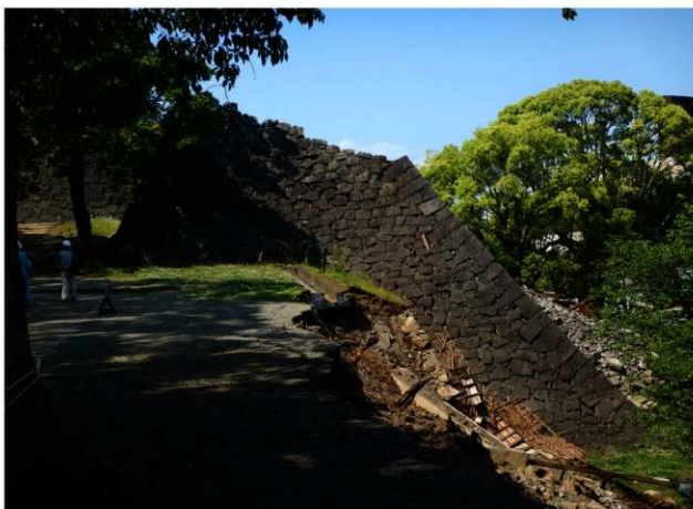
被災後 南から
