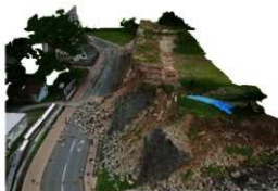
百間石垣崩壊状況 3Dデータ
