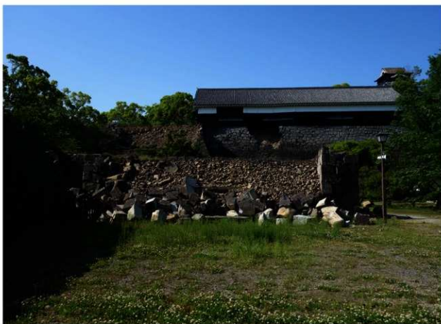
被災後 南から
