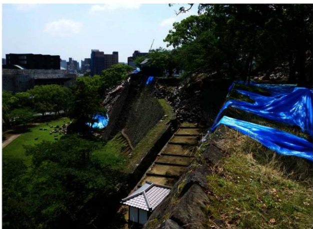
被災後 西から
