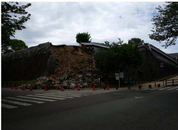
被災後 南東から
