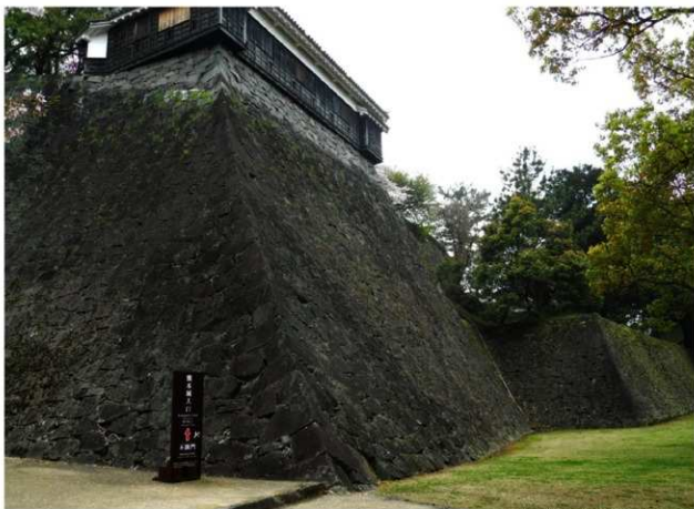
平櫓石垣 被災前 北東から
