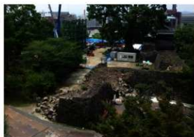
西櫓御門後石垣崩壊状況
