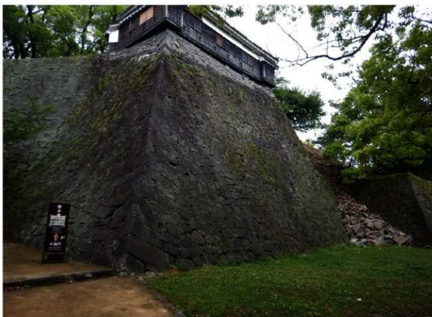
被災後 北東から
