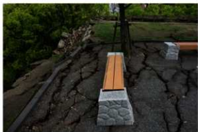
長局槽北側石垣の崩壊と地割れ
