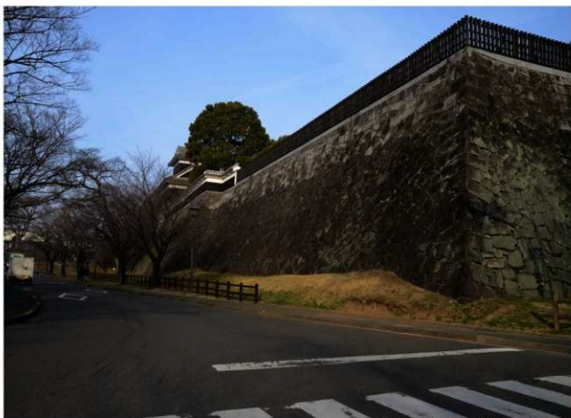
奉行丸南東隅石垣 被災前 南東から
