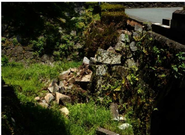
被災後 南西から
