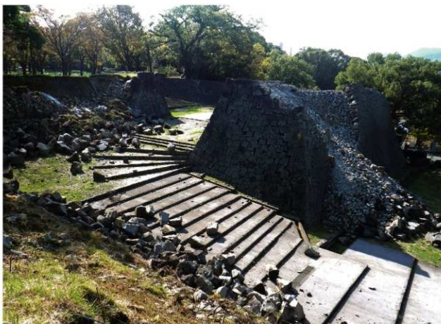
被災後 北東から
