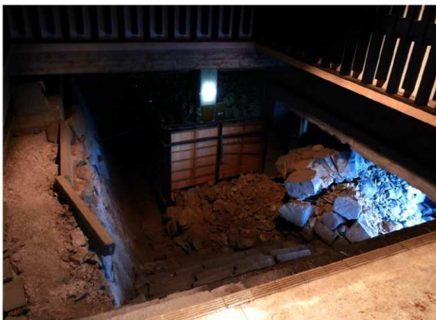
小天守穴蔵 被災後
