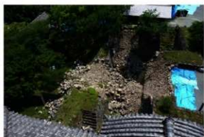
トキ槽と石門上部石壁の崩壊
