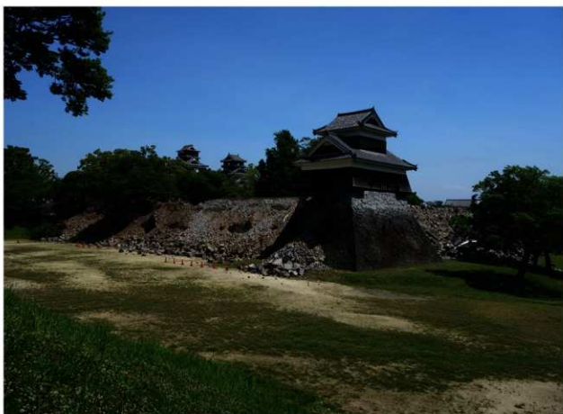
被災後 北西から
