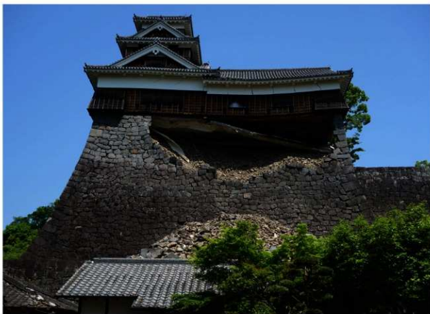
被災後 南から
