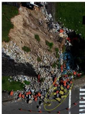
奉行丸南東隅崩落箇所の石材色分け
