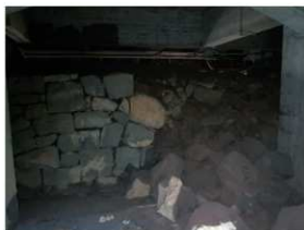
大天守穴蔵石材崩落状況
