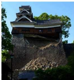
飯田丸南面石垣崩落状況
