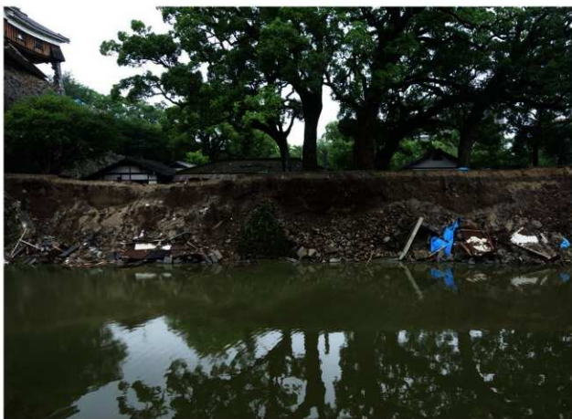
被災後 西から
