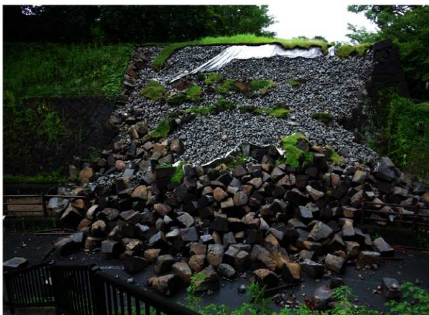
被災後 西から
