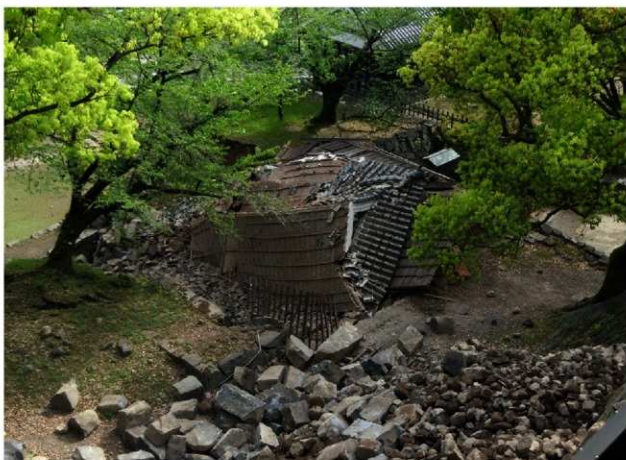
被災後 南西から
