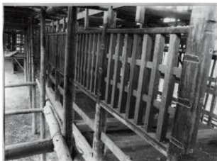
図6-121 要旨一 北十八間櫓南側外部東より② 南側柱に残っている硝掛刺。
