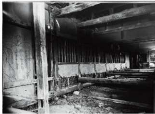
図6-122 要旨一 北十八間櫓南面内部東より③ 内法間間渡穴跡。
