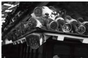
図 6-145 修理前の下屋本瓦葺隅部の状況
