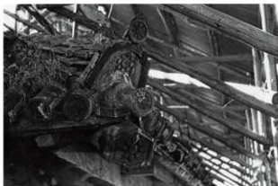
図 6-146 修理前の主屋部本瓦葺隅部の状況
