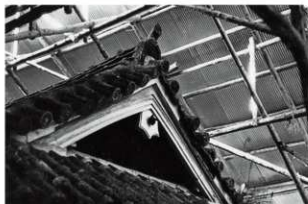
図 6-147 修理前妻の状況
