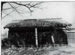
図 6-133 要旨二 五間櫓南面外部② 西より第二間の窓を撤去し壁とする。
