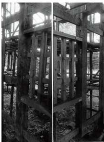
図 6-134 要旨二 五間櫓南面柱向かい合わせ面③ 五ノ一・二内法間に間渡穴と外側に引掛がある。
