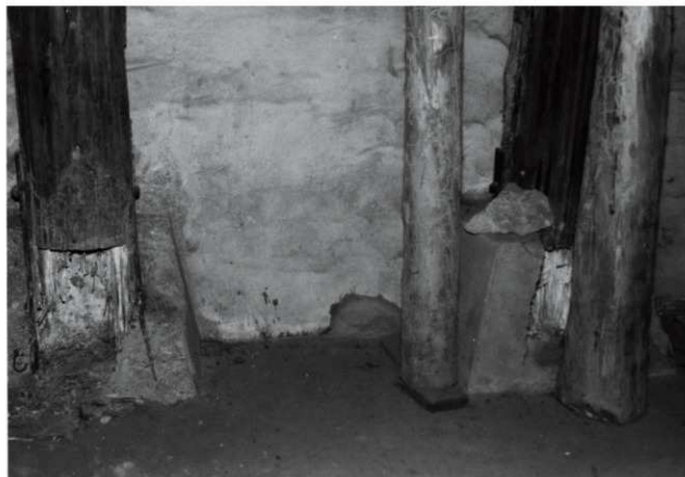
図 6-85 地階柱足下の蟻害状況
