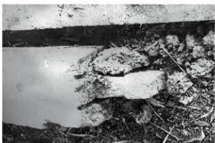
図 6-76 継手の蟻害状況
