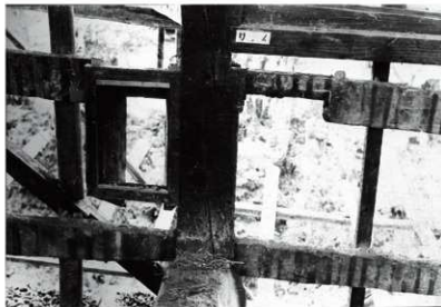
図 6-30 要旨二 (口) 続檜腰貫に残る旧銃眼欠 3 図 6-29 の壁を撤去した状態。文化庁 所蔵。
