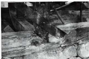
図 6-78 鉄製筋違端部の破損状況
