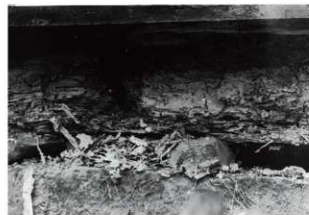
図 6-34 続櫓東側土台腐蝕（位置図 4・5 a ）
