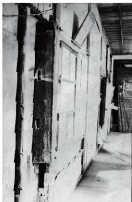
図6-22 要旨一 修理前 壁の間の柱2 壁撤去の状態。窓台、鴨居仕口がある。 文化庁所蔵。
