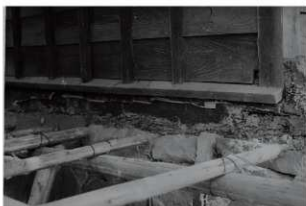
図 6-75 統槽南東隅 土台の腐蝕☆
