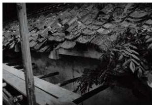
図 6-32 屋根の破損状況
