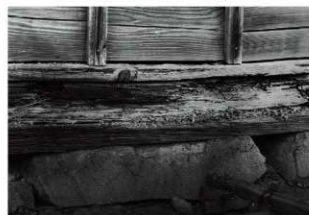
図 6-35 続櫓西側土台腐蝕（位置図 1・2 a ）
