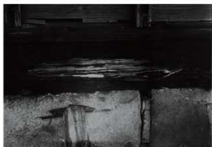
図 6-36 続櫓土台腐朽
