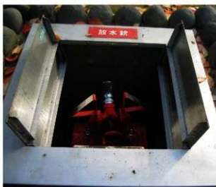
図 5-15 地下式放水銃内部（竹の丸）
