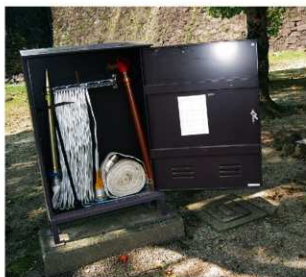
図 5-16 地下式消火栓と格納箱内部（十四間櫓前）
