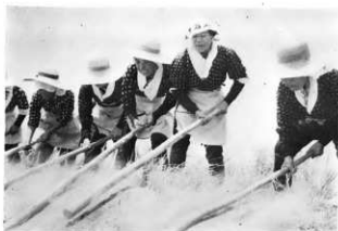
(上)堤防工事に働いた女性達・土端唄をうたいながら連日工事に出た。(大崎福寿撮影)
