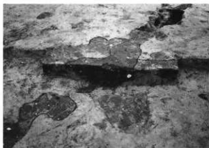
地割れ確認状態 東から
