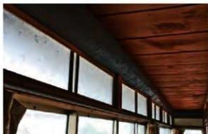
東縁 縁桁は長尺材の杉丸太。化粧合板の敷目天井、欄間は葉の模様を型押しガラス。
