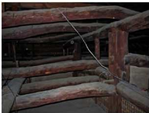
柱の上端を切り縮め、曲がった木材からなる小屋組の位置を ずらして再利用している。
