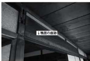
① 中の間一束縁境の差鴨居外側には、式台玄関の鴨居痕跡が見られる。画面左側に②③に見る戸袋が付くので、③の柱に袖壁の痕跡はない。
