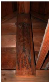
石鳥居札発見状況 御正殿妻の束に釘打ち止め
