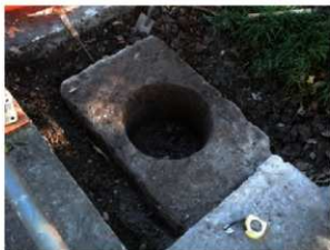
3 【工事対象】正面向かって右側の柱の基石と周囲のコンクリートを撤去した状態。根石が現れた。左右の柱を繋ぐ地中梁のような構造はない。(画面左下が鳥居の中心の向き)
