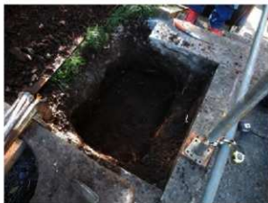
4 根石の下に地葉はなく、地山となる「はに」土の上に直にのる。周囲の樹木の根が育って根石の下に入り込み、石は約30ミリ持ち上げられていた。
