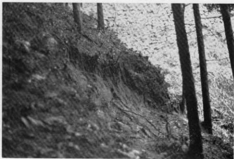
圖版14 百間石垣崩壊箇所
