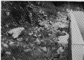
図版2 (I. 百間石垣端部崩壊直後)
