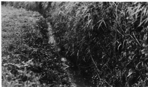
図版11 土堤の斜面が肩より約60cmほどずり落ち用水路をせばめた。
