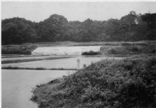
図版12 崩壊箇所の応急防災処置(太宰府町社会教育課職員による)
