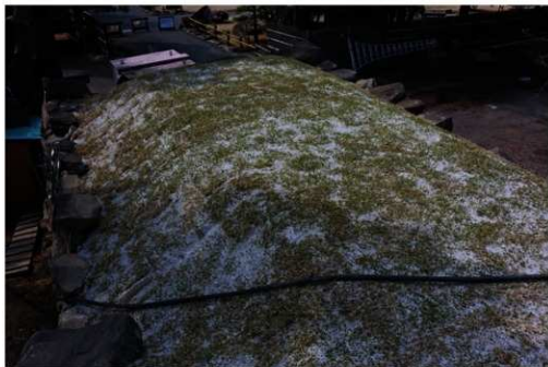
図版 6 竣工後（上面） 石垣上面は、石垣北側の高さと同じになるよう盛土を行い、貼り芝で整備した。
