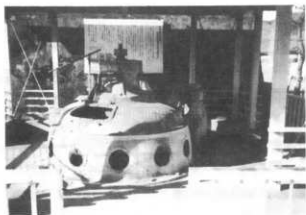
発電機上部 - 写真74
