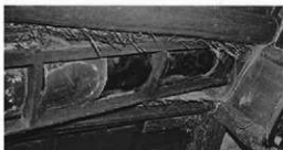
写真1 柳川市旧十二丁松藤キヨ氏宅 漏斗谷の樋柱口
