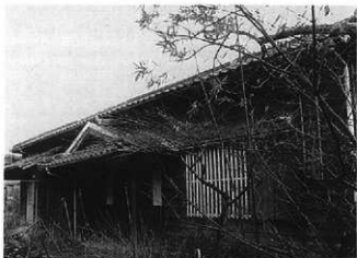
▲ 同上社宅の縁側と東妻部分の状態 (1992年撮影)
