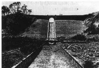
▲ 養福寺貯水池の堰場工事 (1923年撮影【八幡製鐵所土木史】による) 上の写真は貯水池側から見た溢流堰
