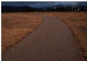
写 5-21 主園路（自然色アスファルト舗装）
