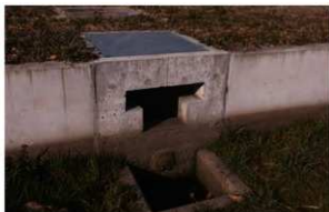
写真1-14 東側多重環境源オリフィス
