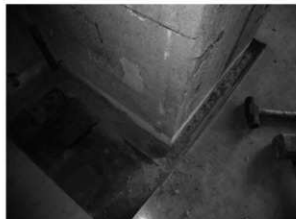
1階南側では、現在の床面の135ミリ下にコンクリート叩きと高さ200ミリの橋木が確認された。
