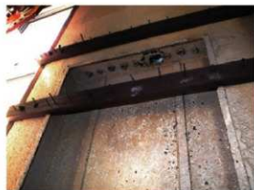
1階西壁 スイッチボード内部見上げ 配線の本数は、防空学校の調光操作盤結線図と一致する ※
