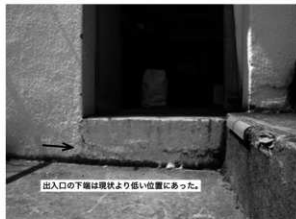
階段踊り場から回廊への出入口は、下縁が低かった痕跡がある。現在の2階床は回廊の上に載せられ、高くなっている。
