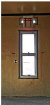
2 階 窓周囲には現状より幅広い額縁が付いていたことが、周囲を塗り直した跡からわかる (→の位置)
