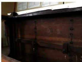
厚板間はボルトで継がれる。切断された斜材端部が残る
