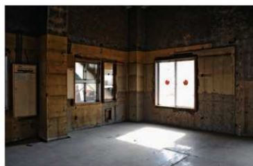
1階室内南東隅 内装材を撤去すると、消防署に最初に改装された当時の壁仕上げが表れた。写真は風呂場と洗面所。この黄色の仕上げは、外壁仕上げの下に残る黄色い仕上げと時代が揃うと思われる。
