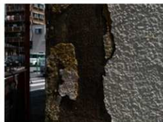
外壁破損部より、仕上げの変遷がわかる。モルタル塗刷毛引き（当初）→黄色吹き付け→白色吹き付け→白色ペンキ塗（現状）
