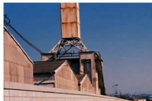
右図詳細。南面中央にはバラベットがなく、起重機を構成した袖壁が残る。(袖壁は次ページ掲載 1974年写真にも写る)
