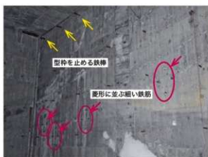
壁の一部には、細い鉄筋が規則的に並ぶとともに、一部は菱形に配置されて突出する。
