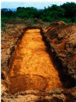
写真171 24T遺構検出状況。(西から) Ⅱ・Ⅵ類と推定される土坑が4基確認された。
