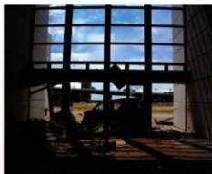
石巻文化センター 入口付近の状況
