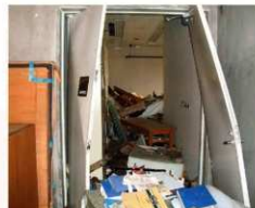
石巻文化センター 学芸資料整理室付近の状況
