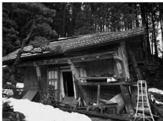
図1 白馬村堀之内地区 建物被害の様子
