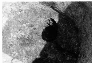
158. P70頭部付近陥没状況 (NW→SE)
