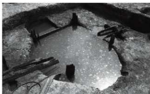
写真10 SE02 冠水状況（北東から）
