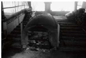
写真4 閉塞状況（焚口側）
