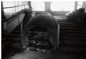
写真4 閉塞状況（焚口側）
