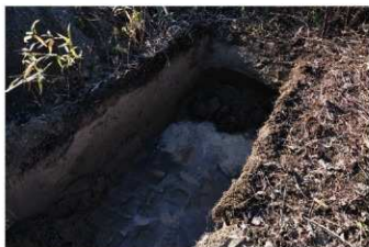
⑥ 26トレンチ 床面湧水状況 (北から)
