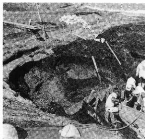
1 斜面部崩落状況 (SW→NE)
