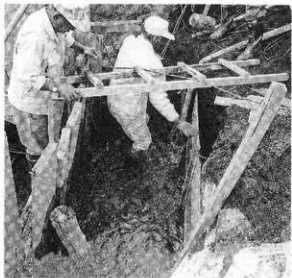
5 6インチポンプ釜堰裏出水状況 (E→W)
