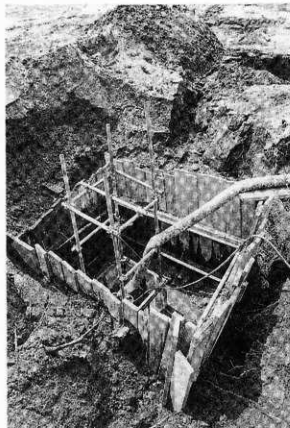
2 釜場周辺の崩落状況 (E→W)
