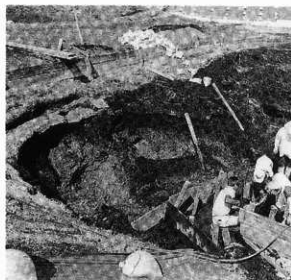
1 斜面部崩落状況 (SW→NE)
