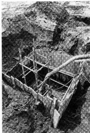
2 釜場周辺の崩落状況 (E→W)
