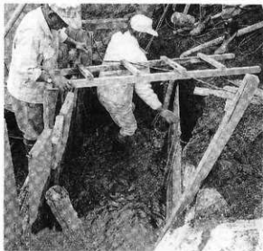
5 6インチポンプ釜場裏出水状況 (E→W)
