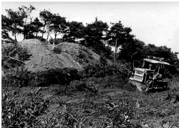
2 1号墳周辺の削平状況（南から）
