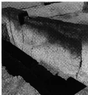
地割れ跡断面
