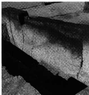
地割れ跡断面
