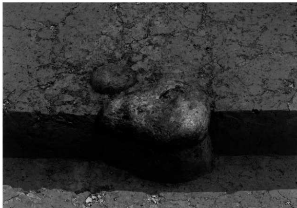
S-21檢出狀況 SW→NE
