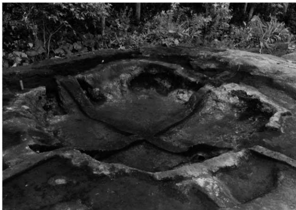
屋根土堆積状況 SE→NW
