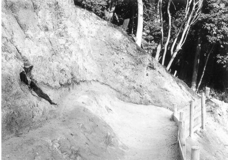
(1) 土砂堆積状況(南西から)
