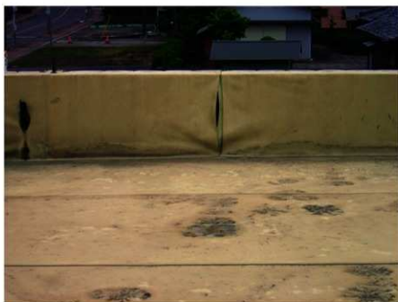
屋上部シートの剥がれ
