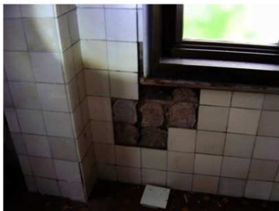
タイルの剥落
