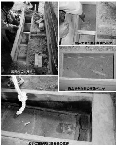
図 12 空気取り入れ弁と送風孔のズレと風箱内のようす
