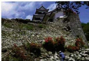
小峰城跡の石垣崩落状況
