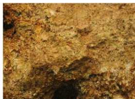
図資 3-11 川の土部 凹凸、ザラツキ感の確認
