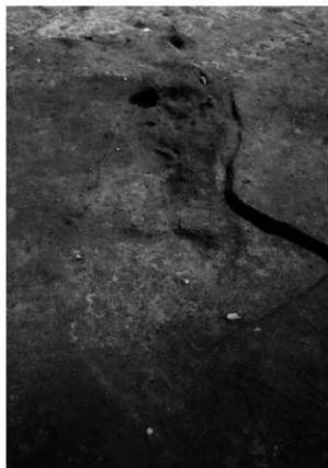
SF11 天井部崩落状況 (N→)
