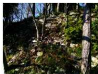
西の丸石垣 樹木が生えている (⑨)
