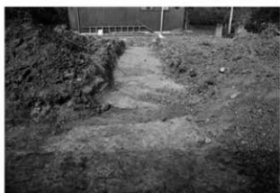
土井城跡（防火水槽）
