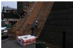
コモ設置状況
