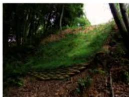
④南B地区：崩れた斜面（養生済）
