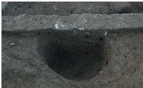
A-1SK1017 断面狀況
