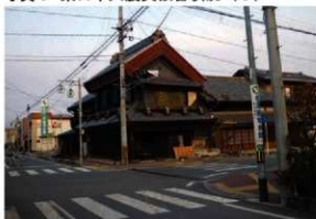
写真11 東日本大震災被害状況 (11)
