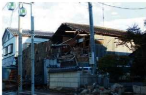
写真5 東日本大震災被害状況（5）
