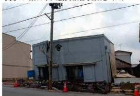
写真12 東日本大震災被害状況 (12)
