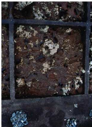
図版78. 112グリッド劣態状況
