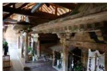
被災した左脇殿上部
