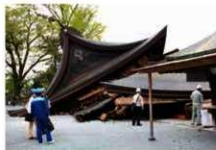
楼門の被災状況
