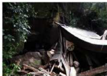
倒壊した本殿（熊本市提供）
