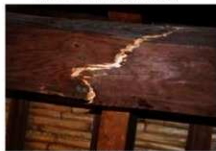
亀裂の入った牛梁
