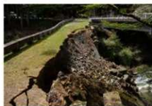
路面から見た被害
