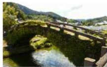
下流側から見た施無長橋（被災後）
