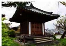
被災後の観音堂
