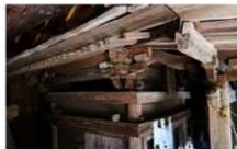
被災した中央殿上部
