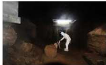
永安寺西古墳覆屋内の被害確認の様子
