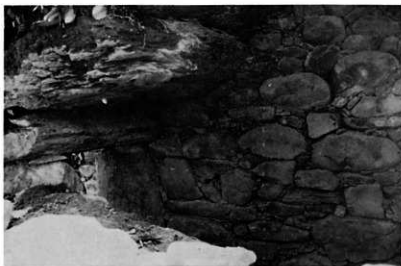
持ち送られた天井構造をみる 左右の立石の上に1枚の天井石を構築し、そこから最高部まで2枚の天井石を持ち送る。
