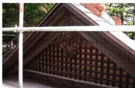
南側妻面・破風・懸魚 面格子裏面はベニヤ張りとなっている
