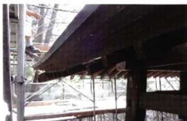
軒先 化粧垂木は部分的にねじれ、野地板から離れている。
