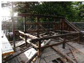
既存小屋組 木組みに関係のないホソ穴が多く、転用材 が使われたと思われる。
