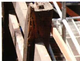
桁撤去後（柱の状況） 上部に腐れ、虫害が見られる。
