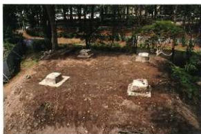
ラップコンクリート検出状況 (南東から)
