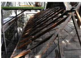
妻側（垂木の状況） 軒先の垂木が切断され補助垂木により折 り上げられている。
