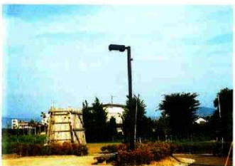
入口広場照明灯 2
