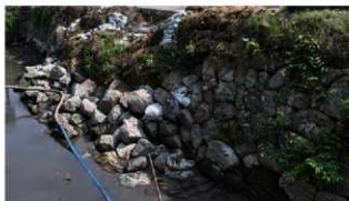
龍岡城跡石垣崩落状況
